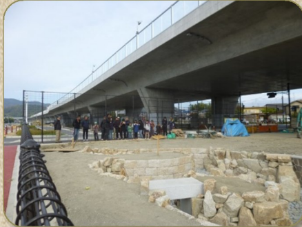
(下海印寺西条) この付近にあった「田苗(たな)池」を、農業用水路と兼ねたものに再現工事中
